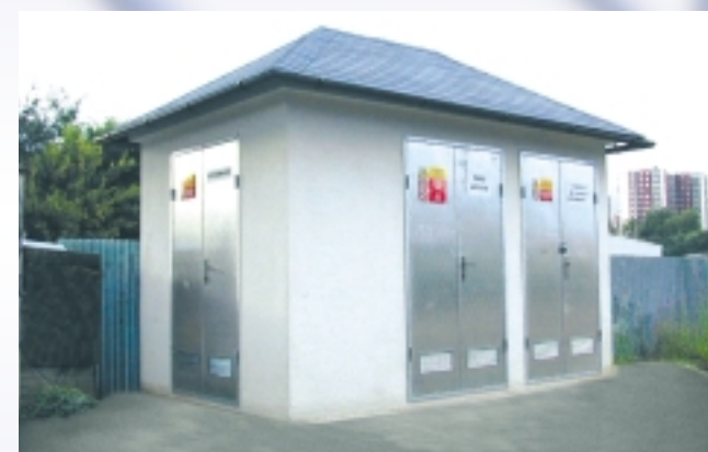
PET® 400 .A.S.A. - Trafostanice napájí multifunkční areál firmy .A.S.A. v Brně. Součástí areálu je administrativní budova, linka na zpracování odpadů, linka na lisování papíru, sklady, autopark.
