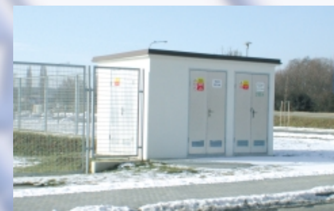
PET® 400 Velux - Trafostanice napájí areál školícího střediska firmy Velux v Brně.
