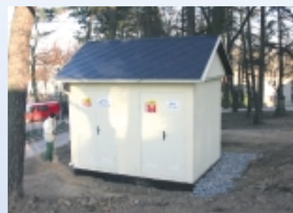
VÍTKOVA - PET® 350 Sedlová střecha - beternit česká taška rozv. vn - siemens 8DJ10/10, rozv. nn - RDO 1000, transformátor 400kVA 11/2002
