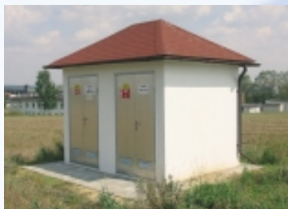
SUS - PET® 350 Valbová střecha - kanadský šindel rozv. vn - PS 24/1, rozv. nn - RDO 1000, transformátor 100kVA 6/2001
