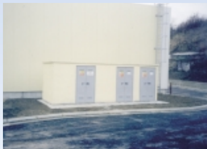
SAPELI - TMT® 700 Plochá střecha, rozv. vn - siemens 8DH10, rozv. nn - RDO 1000 - atyp, transformátor 2 x 630kVA 10/1997
