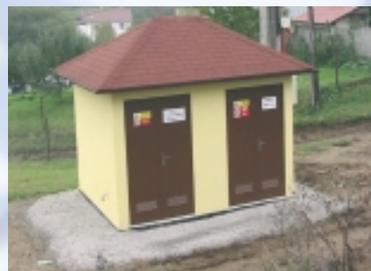
NA PODHOŘE - PET® 350 Valbová střecha - kanadský šindel rozv. vn - siemens 8DJ10/10, rozv. nn - RDO 1000, transformátor 400kVA 9/2002
