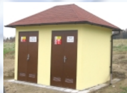
NA VYHLÍDCE - PET® 350 Valbová střecha - kanadský šindel rozv. vn - siemens 8DJ10/10, rozv. nn - RDO 1000, transformátor 400kVA 10/2002
