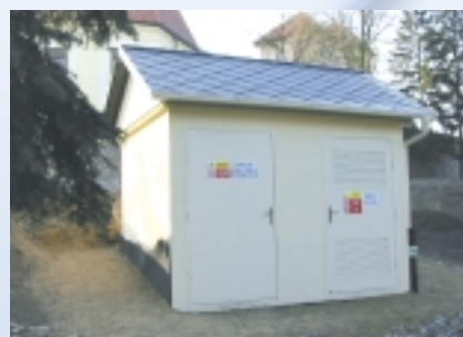
TYRŠOVA - PET® 350 Sedlová střecha - beternit česká taška rozv. vn - siemens 8DJ10/10, rozv. nn - RDO 1000, transformátor 400kVA 11/2002
