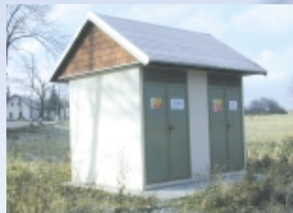
MALÁ CIHELNA - PET® 350 Sedlová střecha - kanadský šindel rozv. vn - PS 24/1, rozv. nn - RDO 1000, transformátor 400kVA 12/1998
